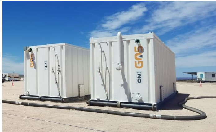
PILETA DE ACUMULACIÓN
